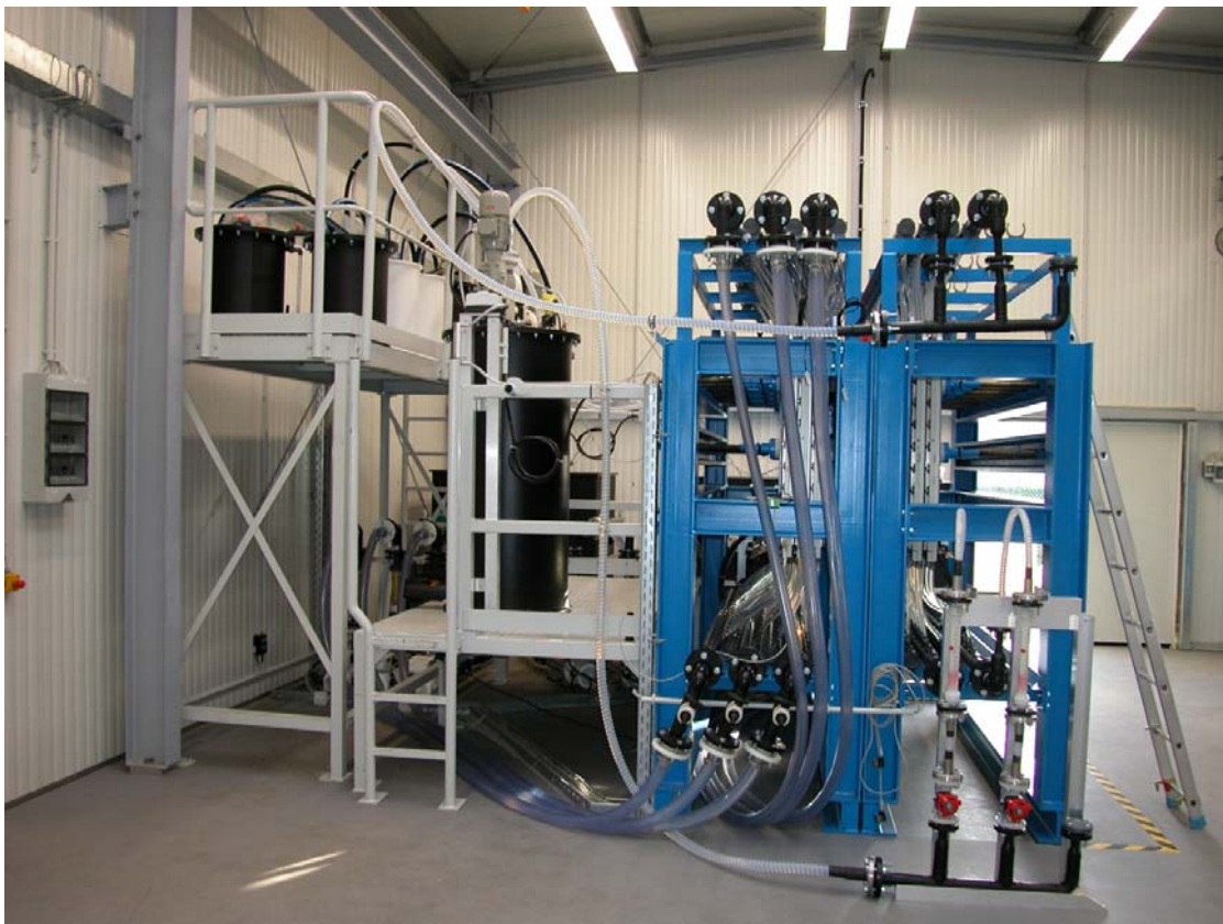
Abbildung 29: Pilotanlage am Standort der GWRA Rainitzta. (Quelle: VKTA Rossendorf)
